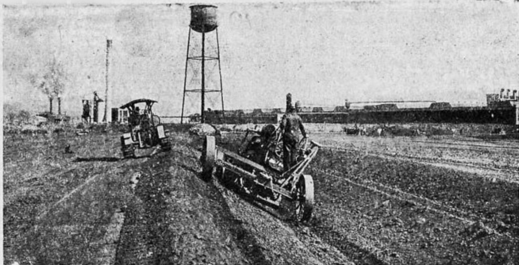
Работы по устройству дорожного полотна, производимые при помощи гусеничных тракторов „Катя пиллер“
